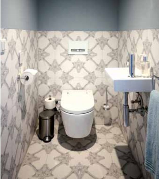
Im Hotel „Leo Grand“ in Wien kommen insgesamt 76 AquaClean Sela zum Einsatz.
